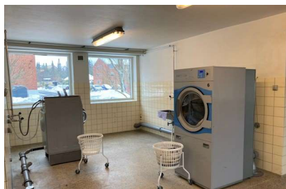
Udskiftning af fælles vaskemaskiner
